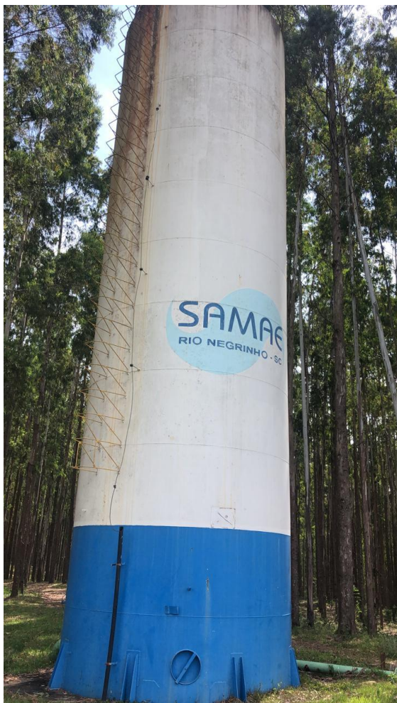
Figura 36. Reservatório de Distribuição - Estação de Tratamento de Água Volta Grande.
