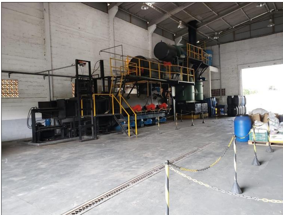
Figura 62. Incinerador da Empresa Hera Sul. Fonte: Empresa Hera Sul, 2019.
