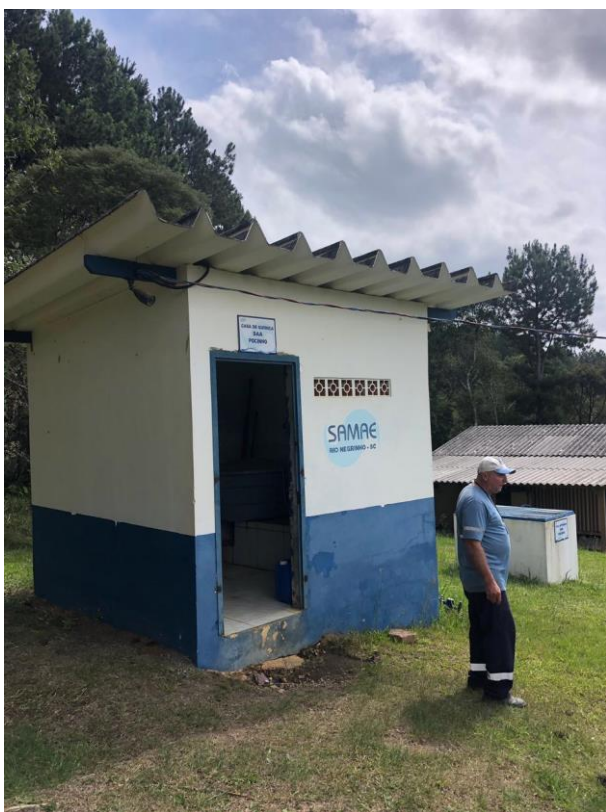
Figura 38. Dosagem de químicos – SAA Pocinho – Vista Externa.
