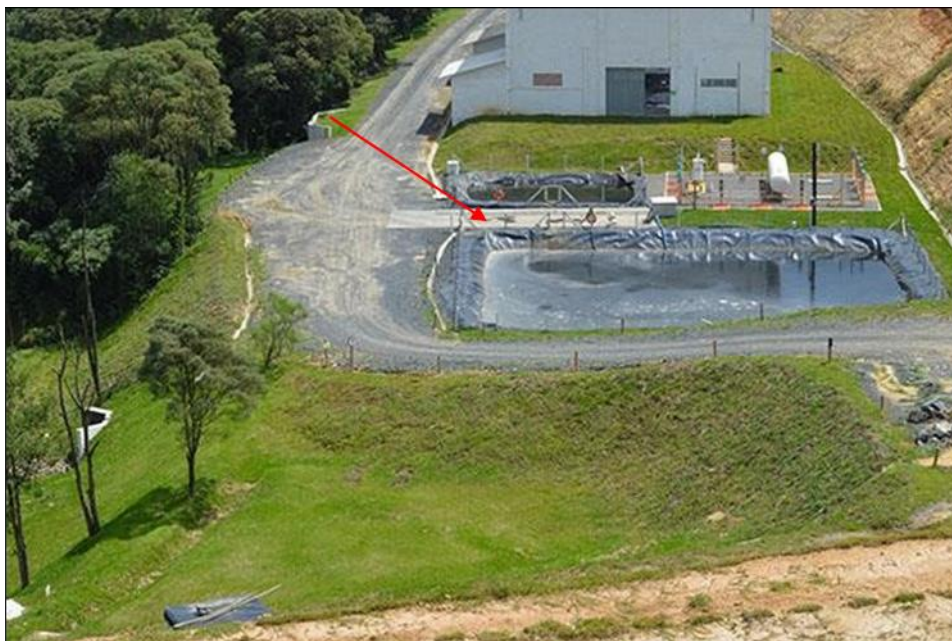
Figura 76. Aterro da Empresa Hera Sul (lagoas de armazenamento temporário de percolados e efluentes). Fonte: Empresa Hera Sul, 2019.
