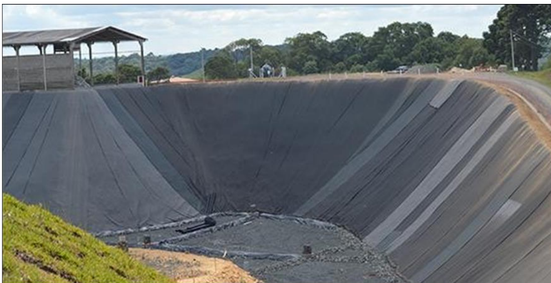
Figura 74. Aterro da Empresa Hera Sul (célula de disposição de resíduos Classe II). Fonte: Empresa Hera Sul, 2019.
