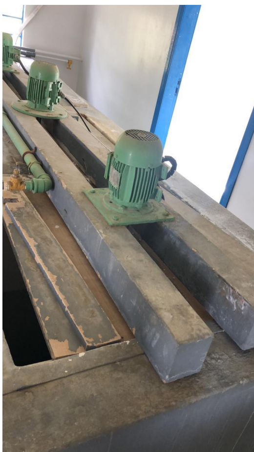
Figura 35. Dosagem de químicos - Estação de Tratamento de Água Volta Grande
