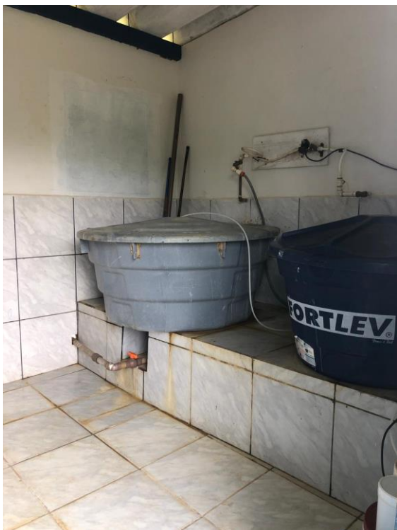
Figura 37. Dosagem de químicos – SAA Pocinho.
