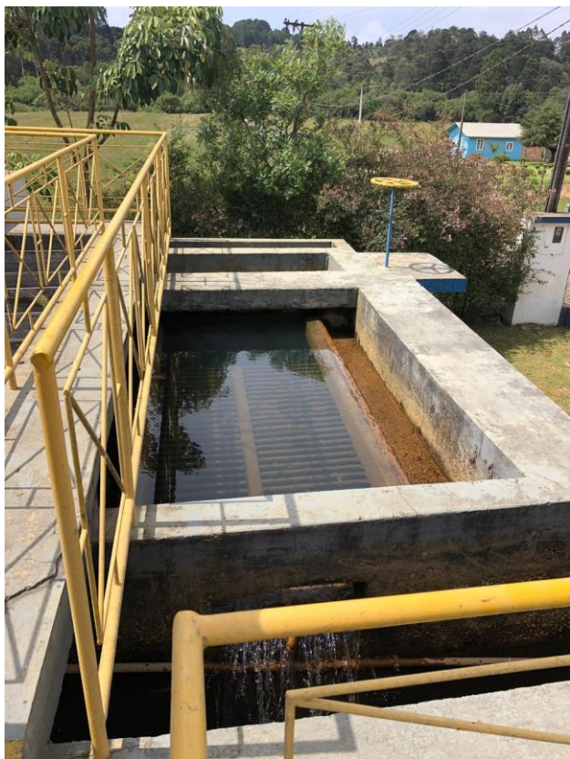
Figura 33. Decantadores de alta taxa – SAA Central
